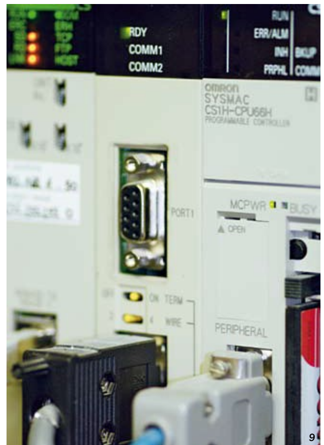
9 - Cuore dell'impianto Niagara di Poggio Renatico è un PLC Omron CS1 con Cpu 66H che gestisce circa 2500 I/O e 200 parametri di misurazione in continuo
